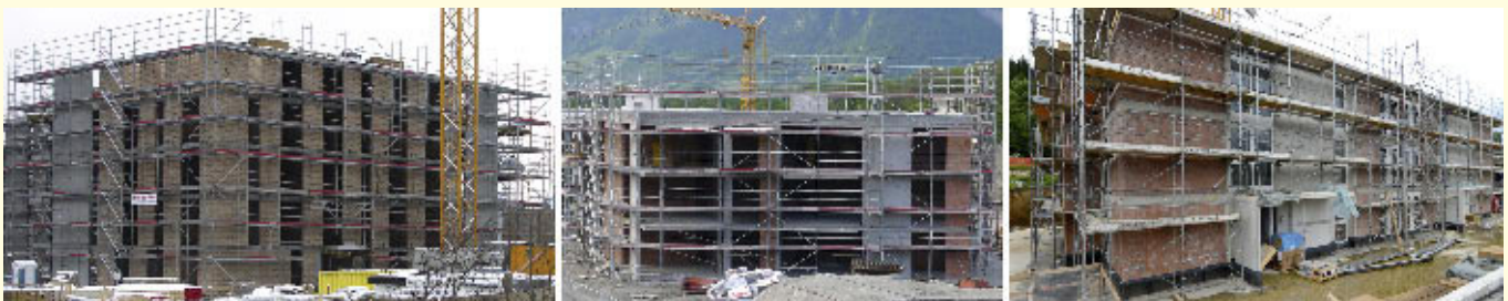
Bild 3. Baustellen von Wohnungsbauten mit Mauerwerks- und Stahlbetontragwänden in Erdbebenzone Z1 (links), in Erdbebenzone Z2 (Mitte) und in Erdbebenzone Z3a (rechts).
