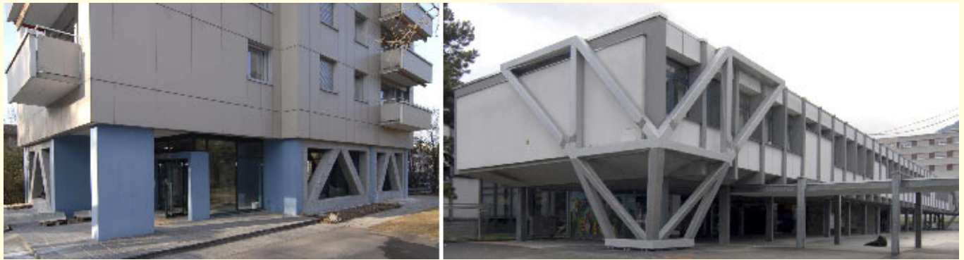
Bild 5. Erdbebenertüchtigung eines Wohngebäudes in Birsfelden bei Basel durch Stahlbetonfachwerke im Erdgeschoss (links) und eines Schulgebäudes in Monthey im Wallis durch räumliche Stahlfachwerke (rechts).
