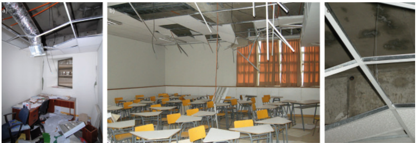
Bild 12. Gebäude für Grundlagenwissenschaften der Universität in Talca: Schäden an nicht-tragenden Bauteilen und Einrichtungen in Büro (a) und Hörsaal (b) sowie Detail der Schäden an der Aufhängung der abgehängten Unterdecke (c).
