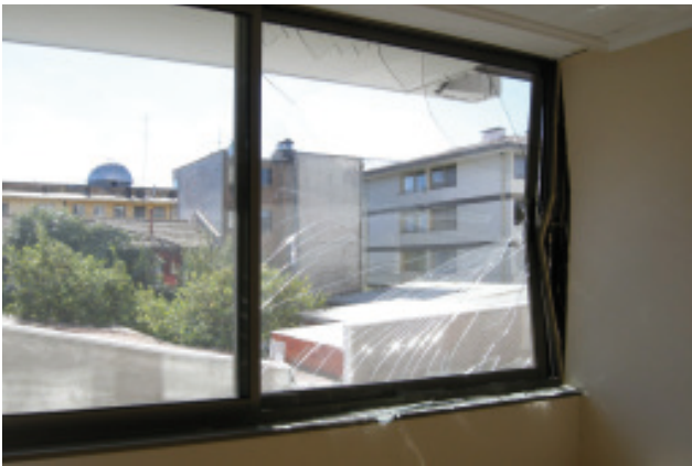
Bild 4. 24-stöckiges Stahlbetontragwandgebäude Castellon 152 in Concepción: Ausgeknickter Fensterrahmen im ersten Obergeschoss.
