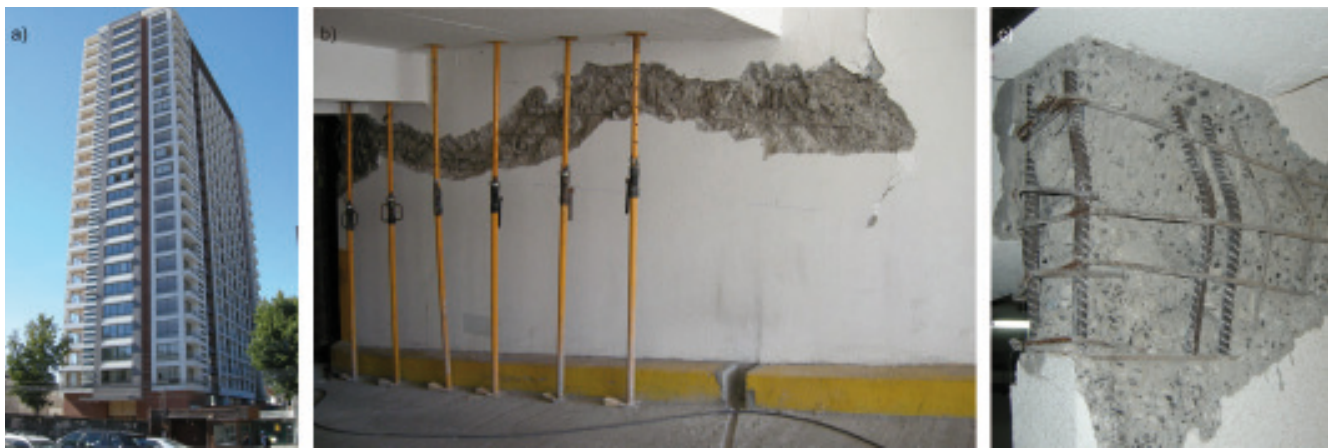
Bild 2. 24-stöckiges Stahlbetontragwandgebäude Castellon 152 in Concepción: Ansicht (a) und Biege-Druckversagen einer Stahlbetontragwand im ersten Untergeschoss (b und c).
