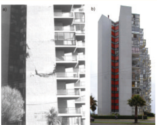
Bild 13. Gebäude Acapulco in Viña del Mar: Schäden an Stahlbeton-Außenwand nach dem Erdbeben 1985 [WWM87] (a) und verstärkte, unbeschädigte Außenwand nach dem Erdbeben 2010 (b).
