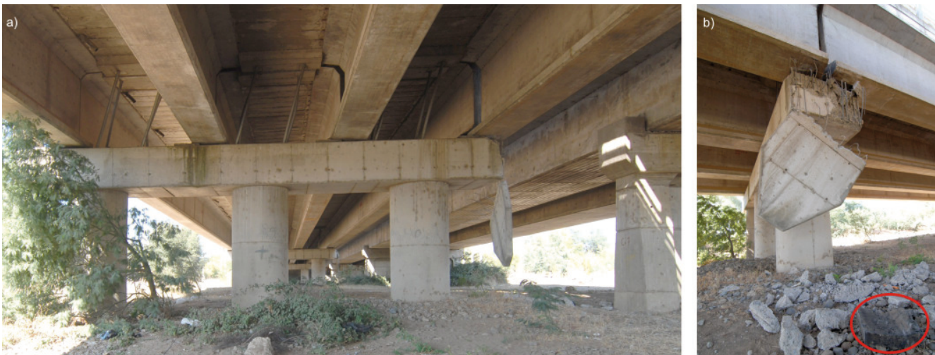
Bild 8. Querverschiebung der Autobahnbrücke „Puente Perquilauqué“: Die Randträger rechts haben den seitlichen Puffer weggeschlagen und sind vom Gummilager auf das Stützenjoch gefallen (a). Ein Gummilager ist auf den Boden gefallen (b, rot umrahmt).
