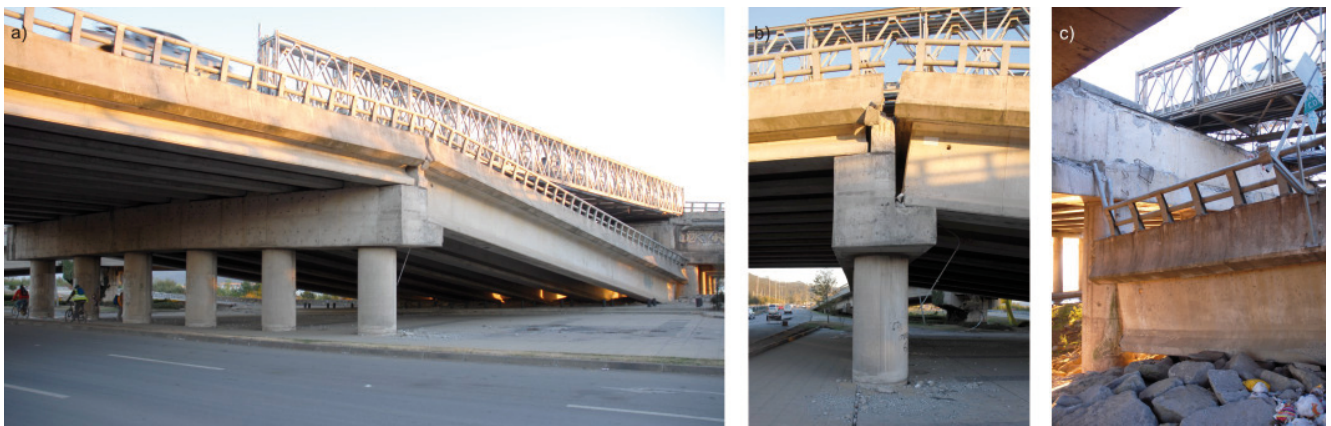
Bild 5. Trägerabsturz bei der neuen vierspurigen Autobahnbrücke „Puente Llacolén“ über den Fluss Biobío in Concepción: Stahlfachwerk-Hilfsbrücke über das abgestürzte Feld (a), landseitige Stütze mit Rissen im Baugrund (b), flussseitige Stütze (c).
