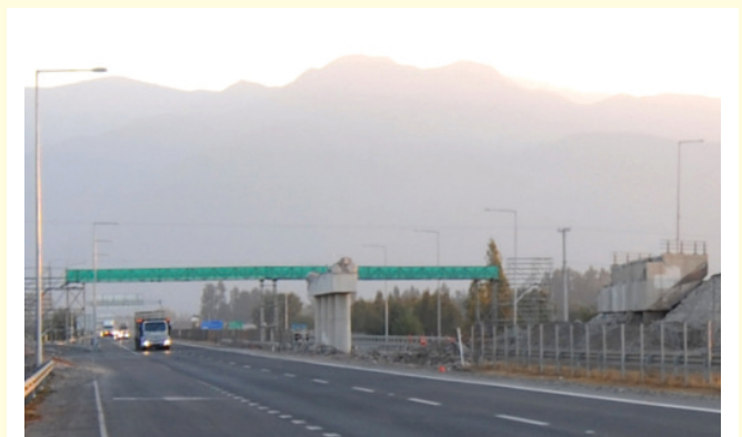
Bild 14. Eingestürzte Überführung bei Ranagua. Die heruntergefallenen Träger sind weggeräumt und eine provisorische Fußgängerpasserelle führt über die Autobahn.
