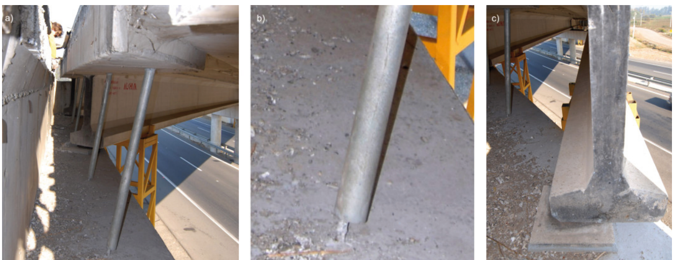
Bild 11. Widerlagerbank der Überführung aus Bild 10. Festhaltevorrückungen zur Aufnahme negativer Auflagerreaktionen (a) bestehend aus je einem Bewehrungsstab geschützt durch ein Stahlrohr (b). Der beinahe abgestürzte Randträger liegt exzentrisch auf dem Mörtelbett des heruntergefallenen Gummilagers auf (c).
