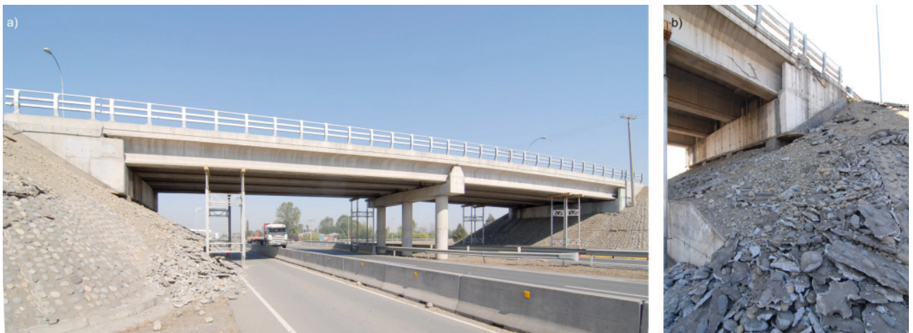
Bild 9. Überführung bei Talca mit kleineren Schäden (a). Setzungen des Strassendamms von ca. 50 cm (b) um das Widerlager links in Bild (a).
