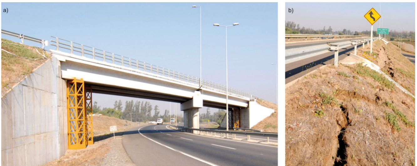
Bild 10. Schief gelagerte Überführung bei Chillán mit mittleren Schäden (a), Risse im aufgeschütteten Strassendamm mit der Überführung im Hintergrund (b).
