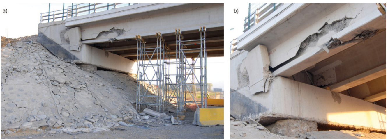
Bild 13. Widerlager der Überführung aus Bild 12. Der Randträger erfährt schwere Schäden im Unterflansch und im Steg beim Anprall an den seitlichen Puffer, der beschädigt stehen blieb (a). Die Träger sind quer von den Lagern gefallen und die Stangen der vertikalen Festhaltevorrückung stehen schräg (b).
