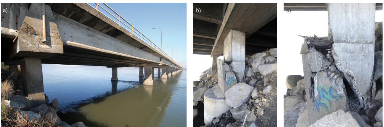
Bild 6. Stützenversagen bei der Brücke „Juan Pablo II“ über den Fluss Biobío in Concepción: Ansicht der Brücke mit den Stützen mit Schubbruch beim Ufer links (a), Detailansicht der Stütze mit Schubbruch (b und c).
