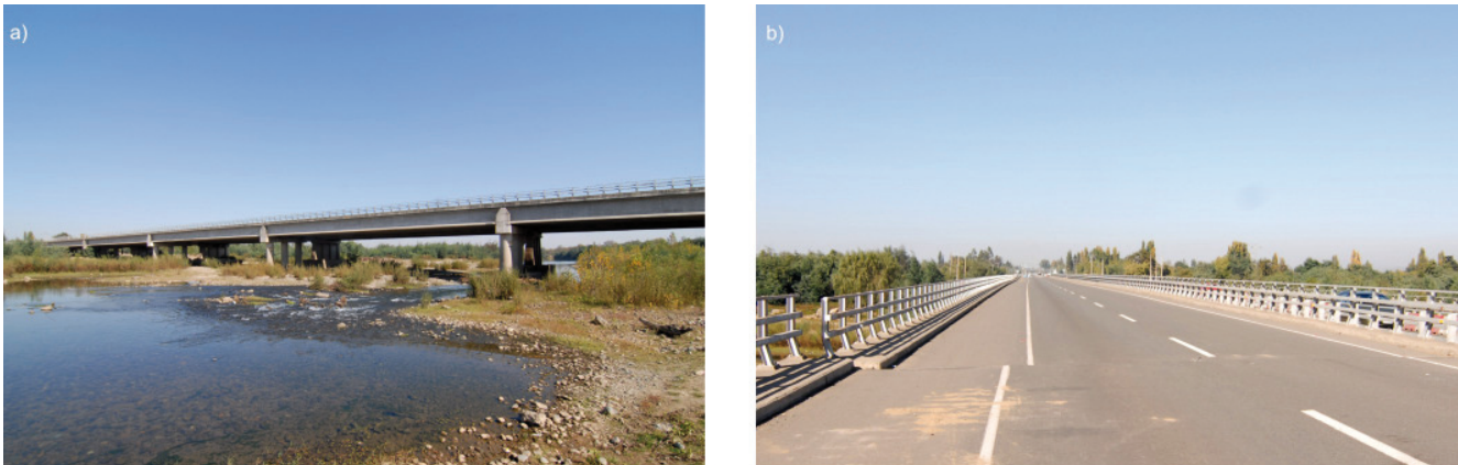
Bild 7. Querverschiebung der Autobahnbrücke „Puente Perquilauqué“: Ansicht (a), Querversatz des Geländers und der Sicherheitslinie bei der Dilatationsfuge (b).
