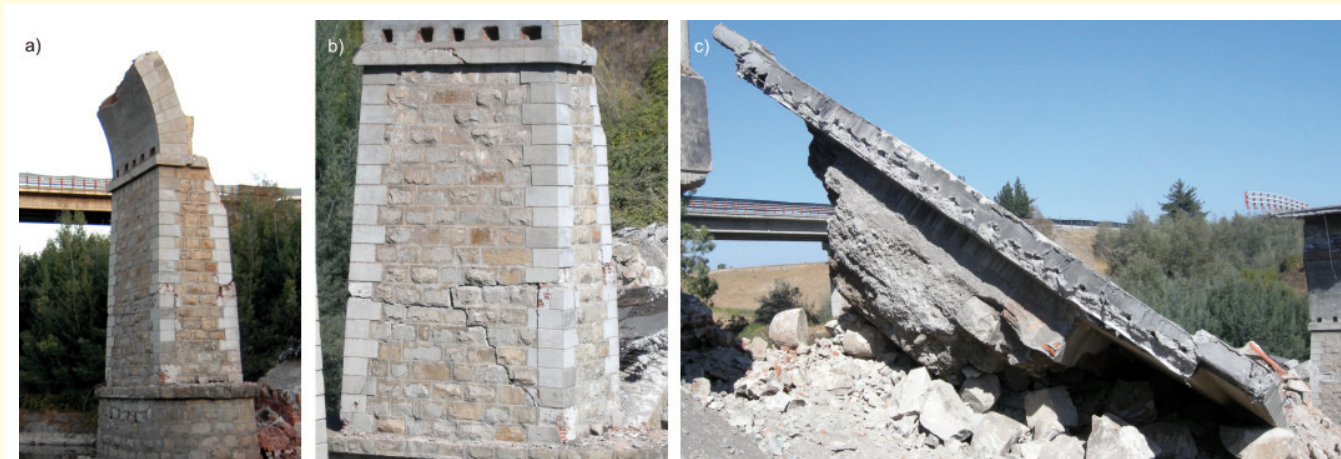
Bild 3. Eingestürzte 7-feldrige Bogenbrücke aus Natursteinmauerwerk über den Rio Claro: X-förmige Schubrisse in der unteren Längs- und Querseite eines stehengebliebenen Pfeilers (a und b) und Überreste eines Bogens mit nachträglich aufbetonierter Stahlbetonplatte zur Verbreiterung der Fahrbahn (c).
