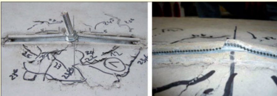
Bild 9. Versagensform für zentrische Zugbelastung in Feldmitte: Globale Biegung der Ankerschiene (links) und lokales Aufbiegen und Reißen der Schienenlippe
